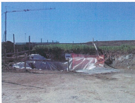
Fotografia 22 - Zona de lavagem de caleiras das autobetoneiras
